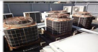
空調機が古くなっていて冷えない・・・
