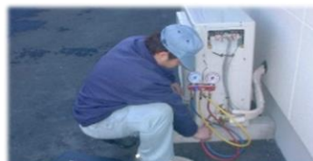
原因がわからないが壊れているので見てほしい
