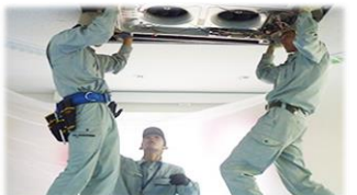
空調機を入れ替えたい！ 増やしたい！
