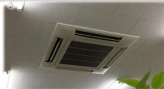
最近、冷房の効きが悪くなった・・・
