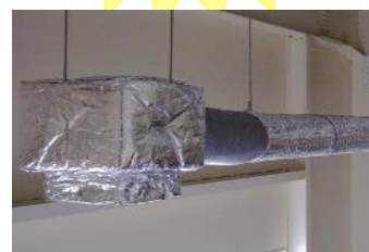
冷房の吹き出し口から 結露する・・・
