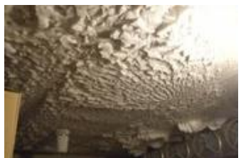
冷蔵庫の天井面に水滴が 氷結している・・・
