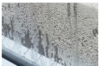
窓ガラスが 結露する・・・
