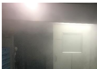
蒸気が蔓延して、天井で 結露する・・・
