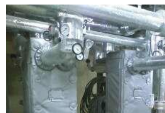
熱交換器が 結露する・・・
