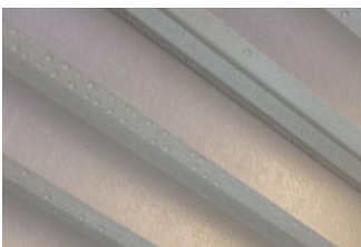
天井裏で結露が 発生する・・・
