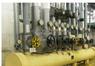
蒸気配管がむき出で 結露する・・・
