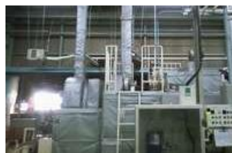
乾燥機などの熱源設備が 結露する・・・
