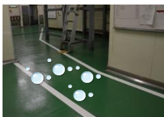
天井面に水滴ができ、 床にポタポタ落ちる・・・
