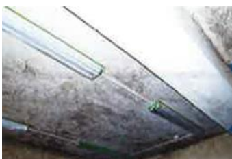
天井面に結露が原因で カビが発生している・・・
